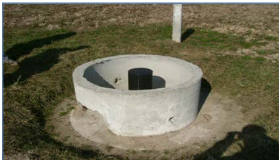
Рис. 4.11. Колодец-поглотитель (крышка снята)
