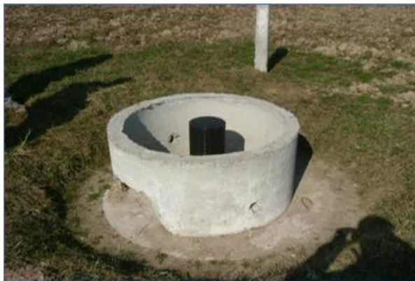
Рис. 4.16. Колодец-поглотитель (крышка снята)
