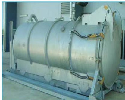
Рис. 1.51. Вакуумная система утилизации отходов компании «Viscon»
