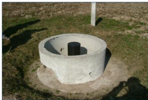
Рис. 2.16. Колодец-поглотитель (крышка снята)
