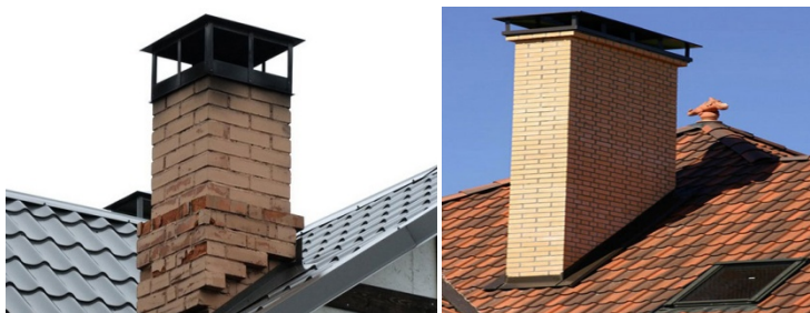
Рис. 22. Пример дымовой и вентиляционной труб
