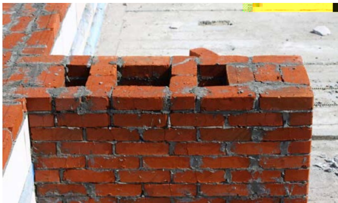
Рис. 20. Вентиляционный стояк жилого дома
