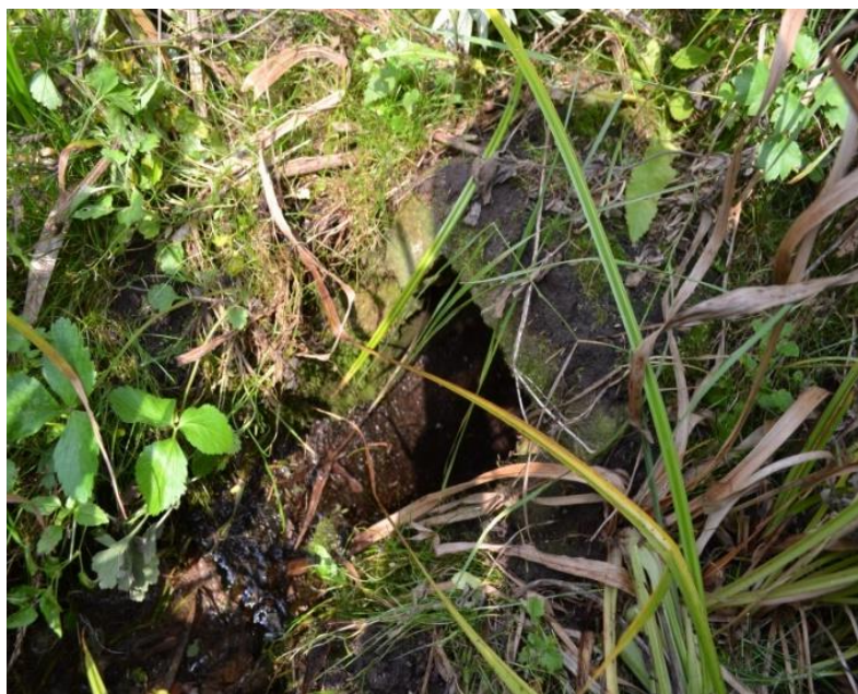
Рис. 2. Разрушенное и заросшее железобетонное устье
