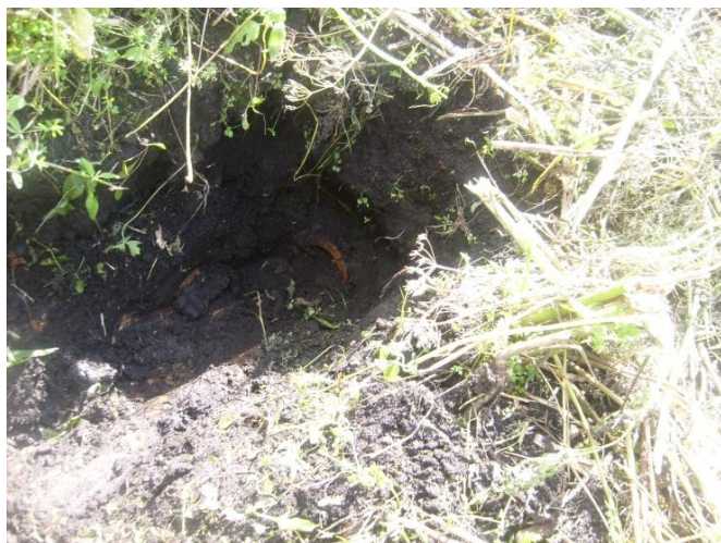
Рис. 1. Разрушение и закупорка керамической дренажной трубки
