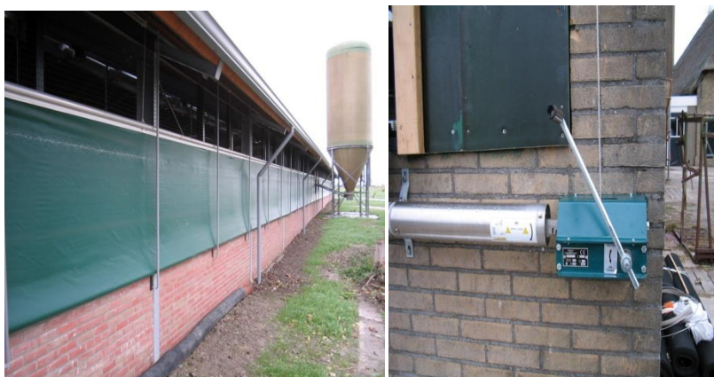
Рис. 2.17. Шторная система вентиляции в коровнике с автоматическим управлением
