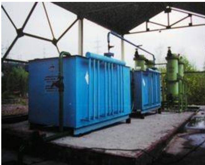
Рис. 7.9. Автоматическая насосная станция
