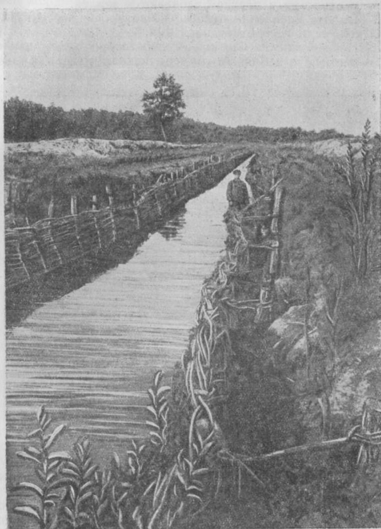
Рис. 56. Разрушенное крепление откоса вертикальным плетнем.
