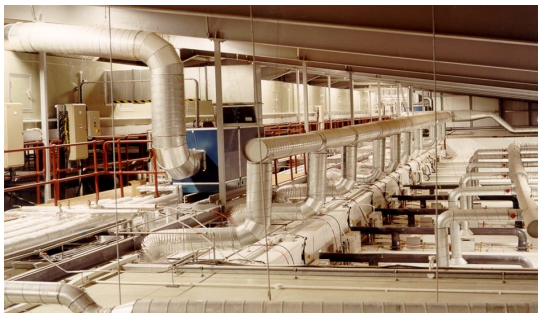
Рис. 26. Основной воздуховод вентиляционной системы
