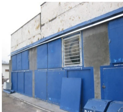
Рис. 14. Вытяжные вентиляторы в заднем торце помещения
