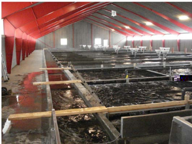
Рис. 5. Вид системы с южной части здания с биологическим фильтром на переднем плане
