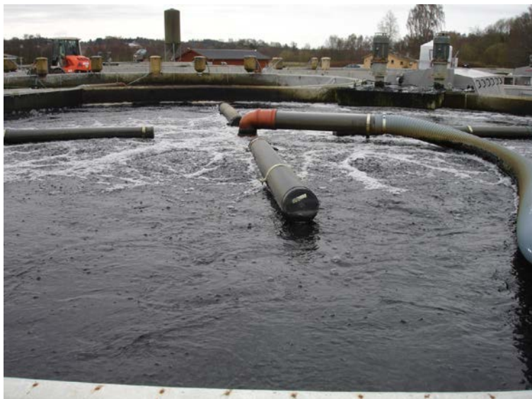
Рис. 7. Биофильтр и подающий воздух трубопровод
