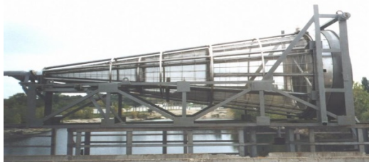
Рис. 7.23. Рыбозащитное устройство с конусообразной защитной сеткой на водозаборе Приволжской оросительной системы
