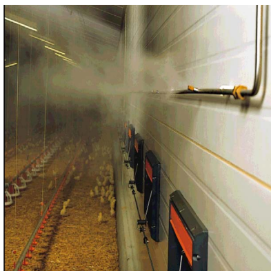
Рис. 1.4. Система увлажнения с форсунками высокого давления
