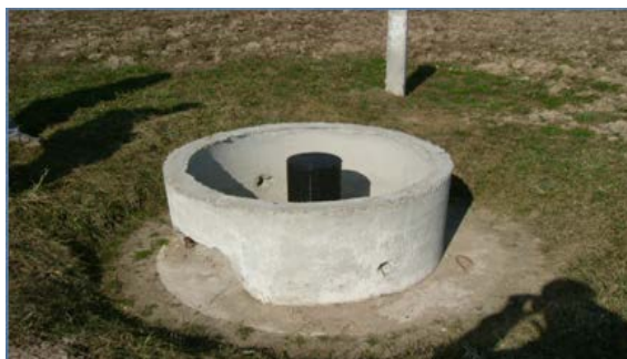
Рис. 3.7. Колодец-поглотитель (крышка снята)
