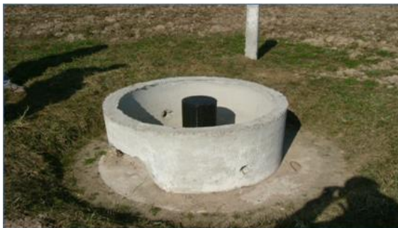
Рис. 4.11. Колодец-поглотитель (крышка снята)
