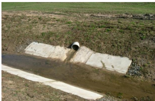
Рис. 4.10. Асбестоцементное дренажное устье
