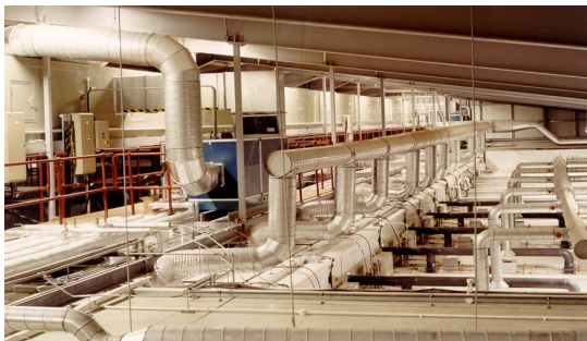
Рис. 26. Основной воздуховод вентиляционной системы
